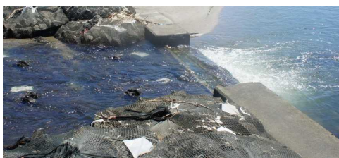
Fig.2 導流堤の低い部分
