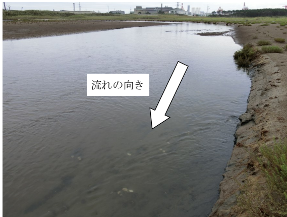
Fig.2 水流により浸食されている（南側より撮影）
