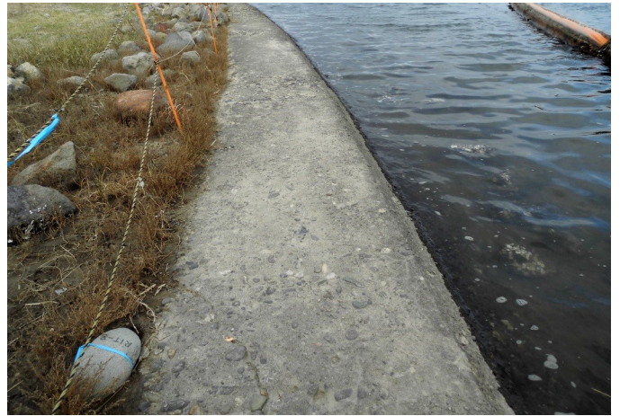
(Fig.4 先月泥が堆積した部分)
