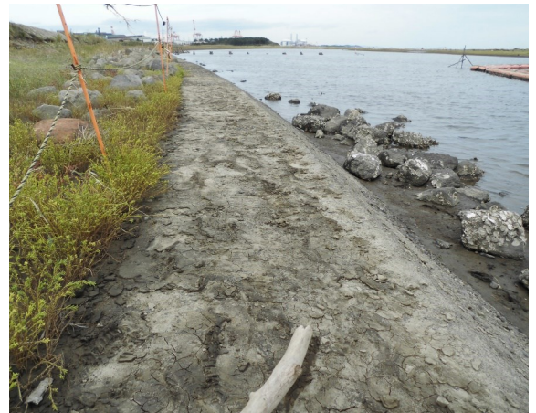
(Fig.2 Fig.1★部分の泥の堆積)
