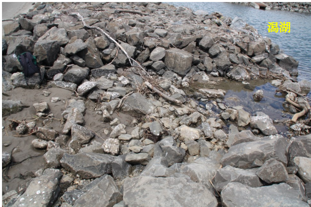
Fig.2 砂の堆積により閉塞した西側通水部分
