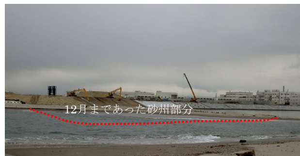
Fig.5 浸食された対岸(右岸)の砂州
